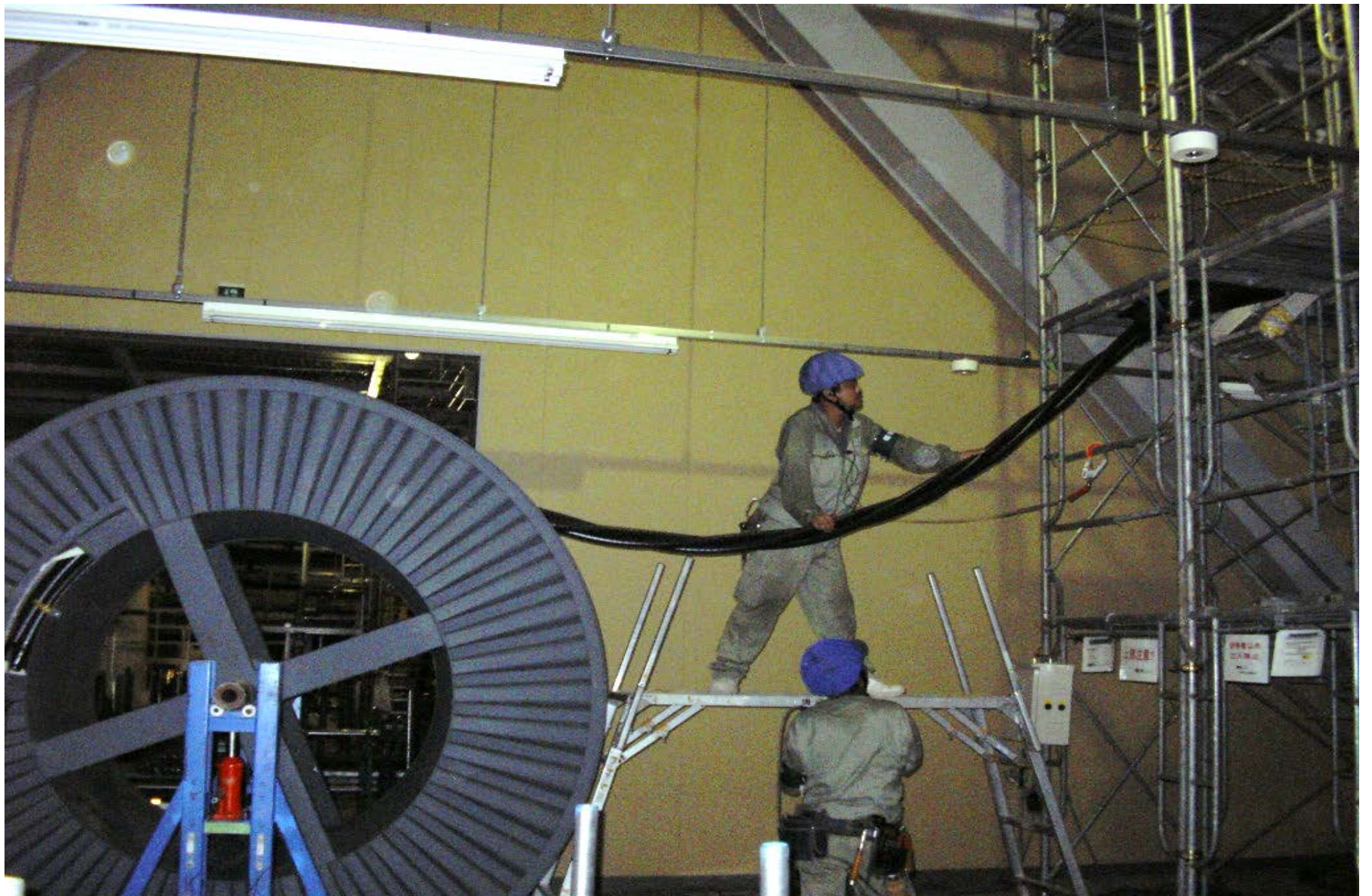
パナソニック尼崎PDP5高圧幹線ケーブル布設工事 6KV-CVT500～600m/m
