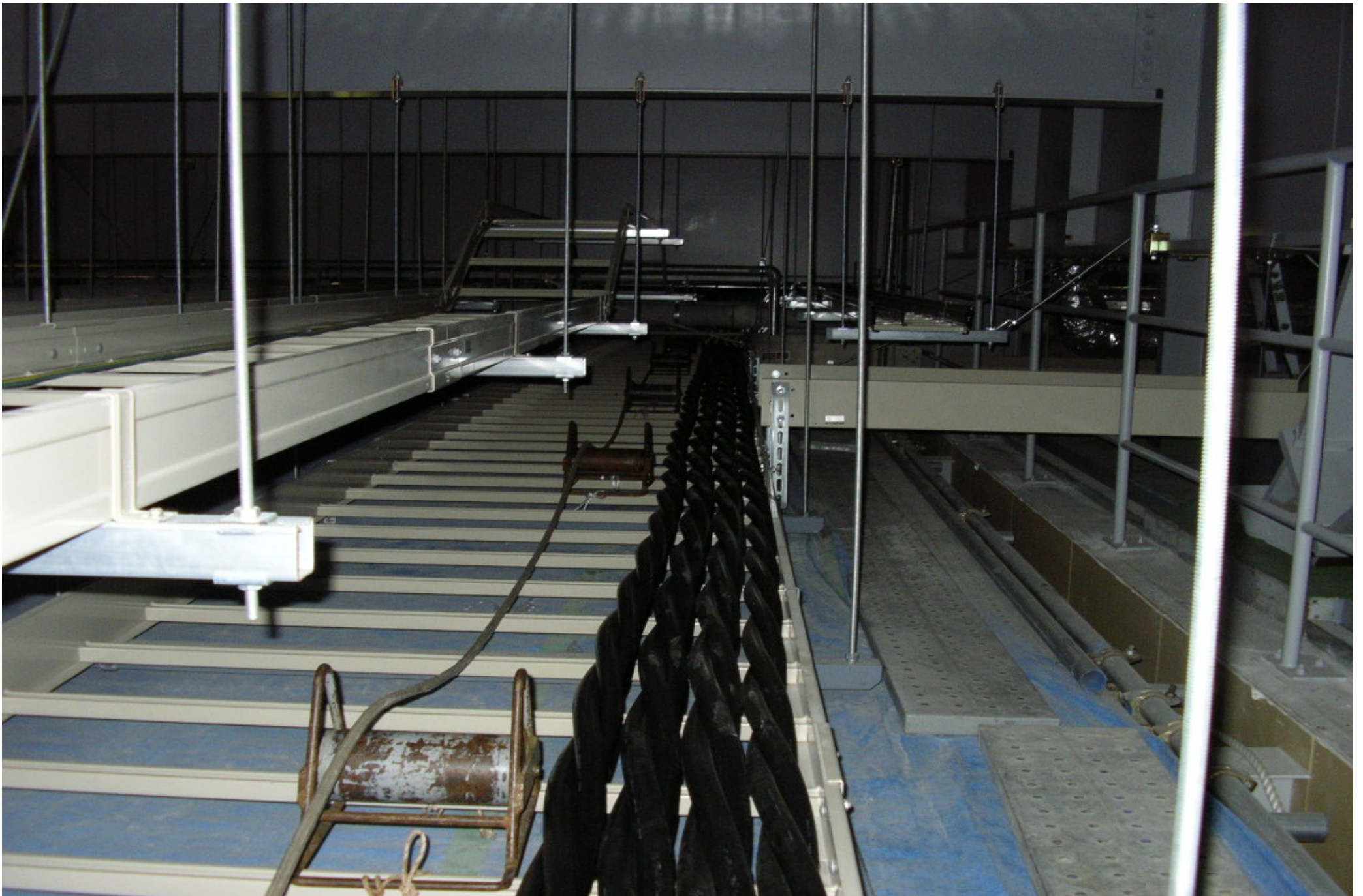
パナソニック尼崎PDP5高压幹線ケーブル布設工事 6KV-CVT500~600m/m
