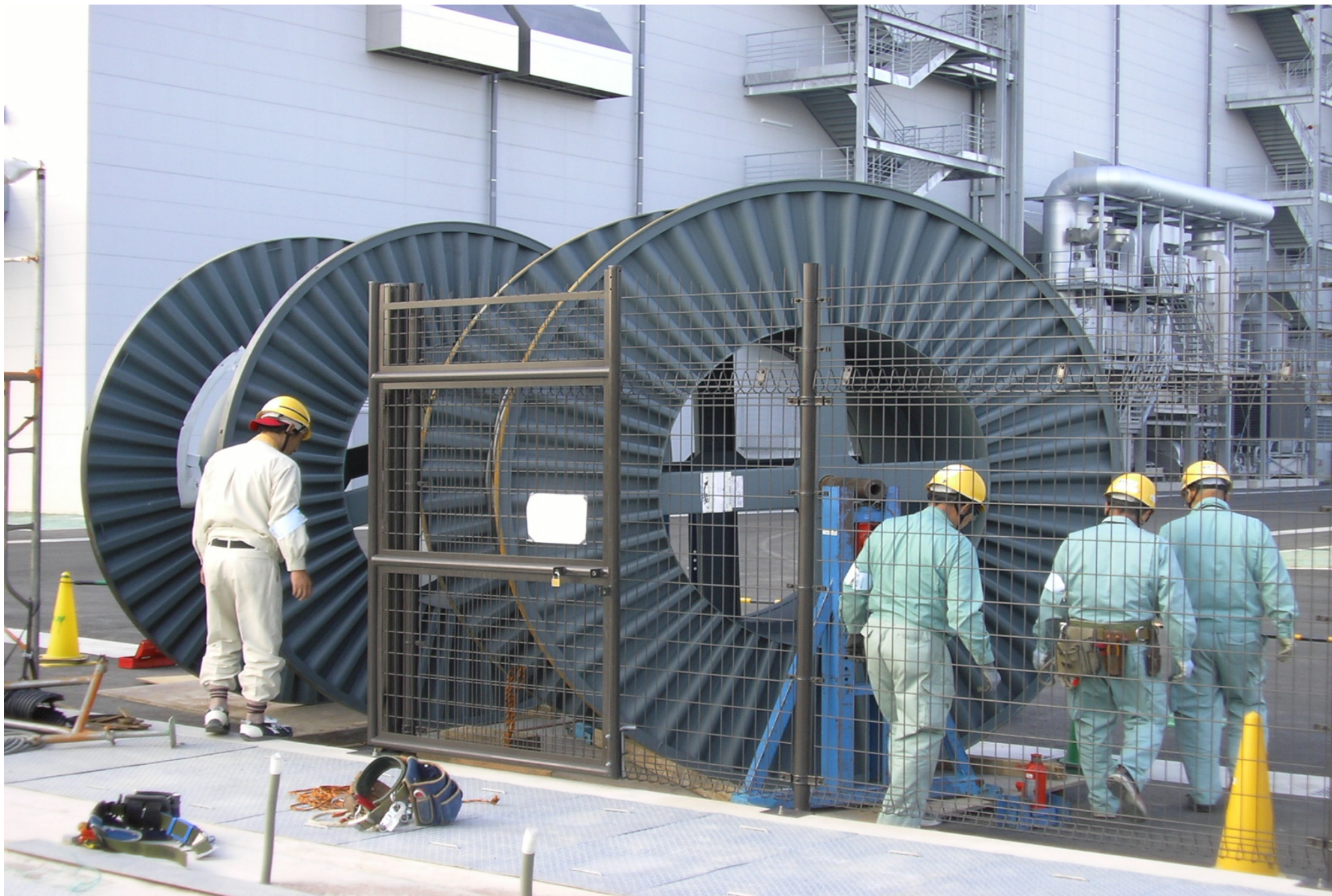
パナソニック エナジー社 住之江工場 高圧幹線ケーブル (H21.10.5~10.20) 6KV-C 6KV-CVT500° -450m ノージョイント (栗原工業株)
